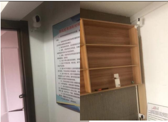
探伤室摄像头安置情况
