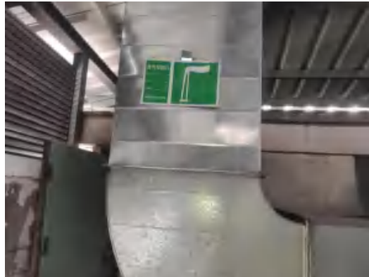
西餐厨房油烟排口
