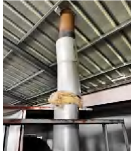
锅炉燃烧废气排口
