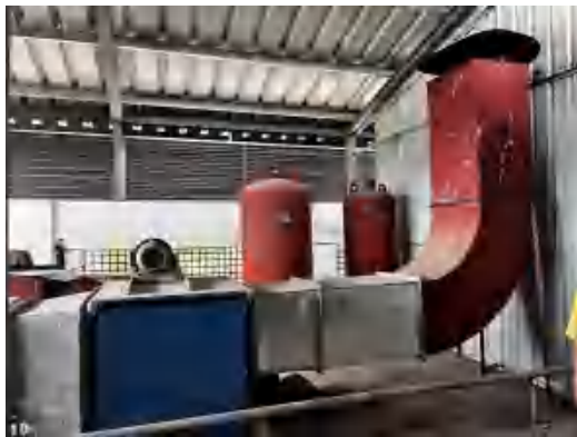
中餐厨房油烟排口
