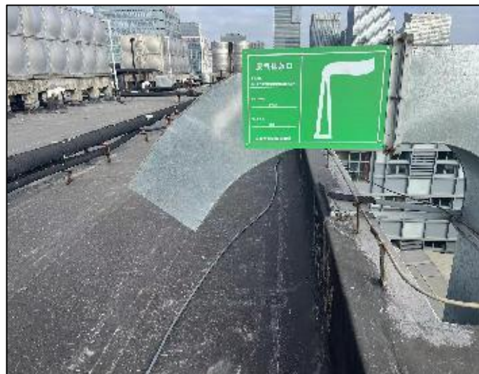
图 4-2 废气排口（食堂油烟废气）
