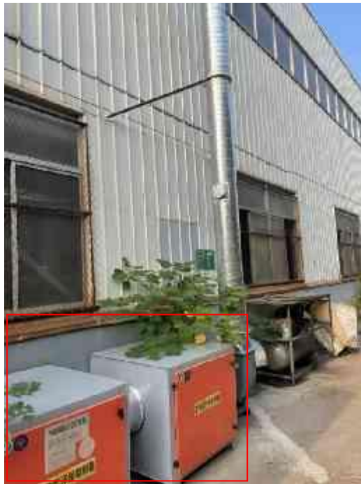
挤出废气处理设施
