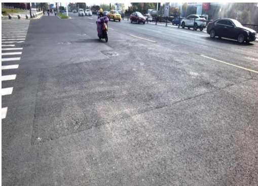
图 3-4 道路修补现状
