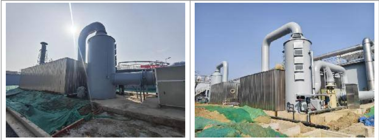
图 4.1-1 废气收集、治理设施照片
