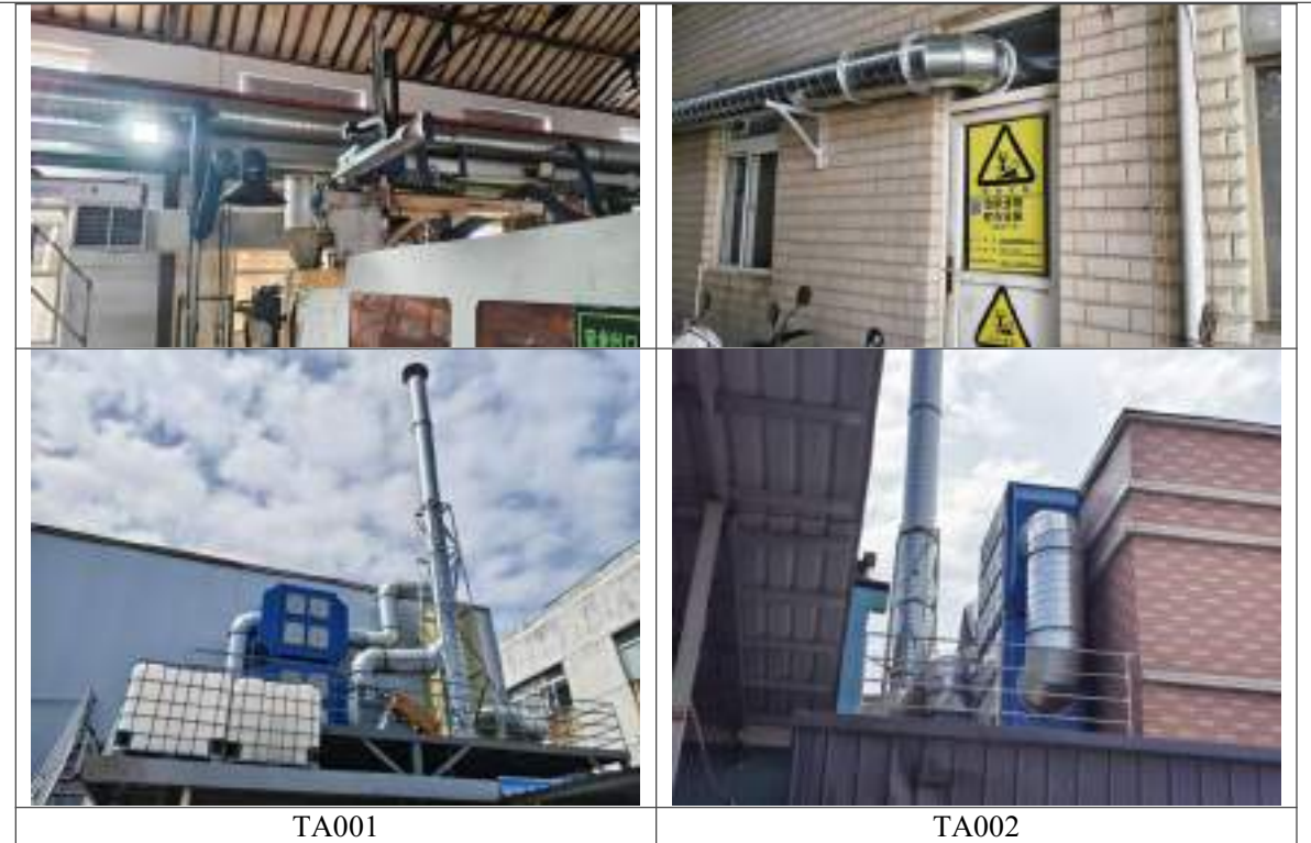
图 3-1 废气治理设施图
