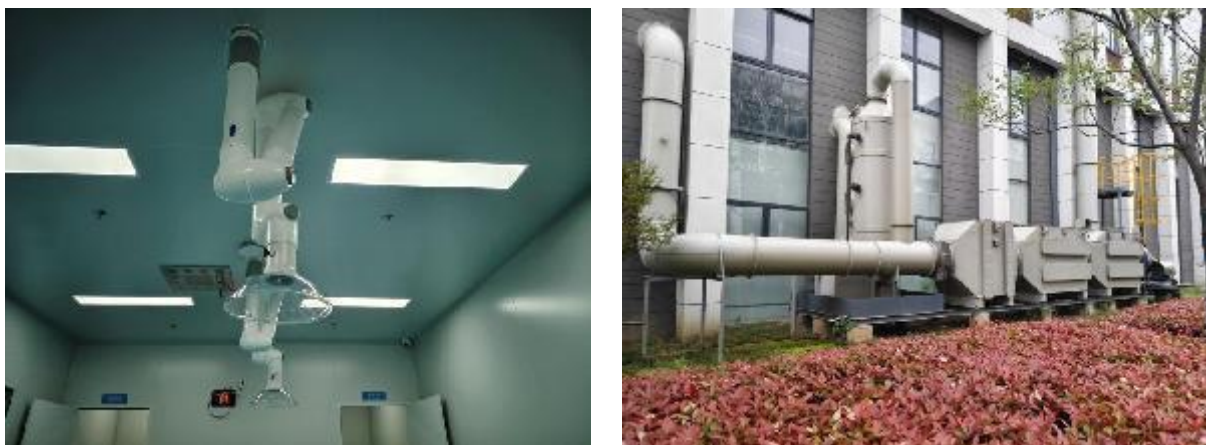
图 4.1-4 废气治理设施及排气筒照片
